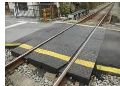
踏切ゴムパネル
