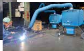
工場内の粉塵対策の実施
