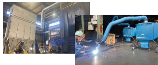
工場内の粉塵対策の実施
