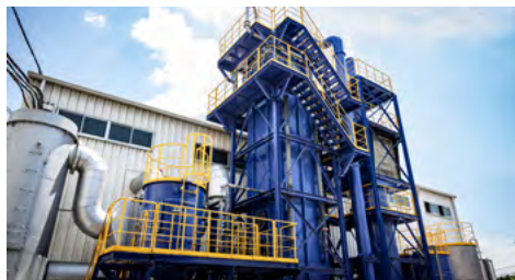
富士宮工場環境設備
